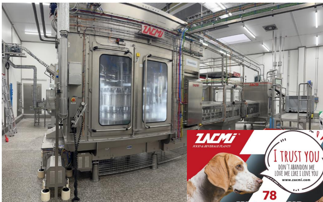
Füllen und Verschließen mit ZACMI „The Filling Company“
